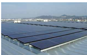
Solar panels (Komaki Plant)
