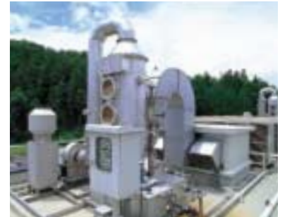
排気ガス処理施設（伊勢工場）
